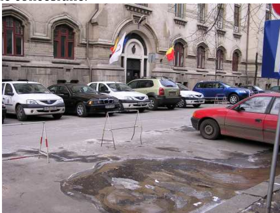
Fig.6 Exemplu de avarie aparuta in perioada timpului friguros in parcarea PMB – 23 ianuarie 2006
