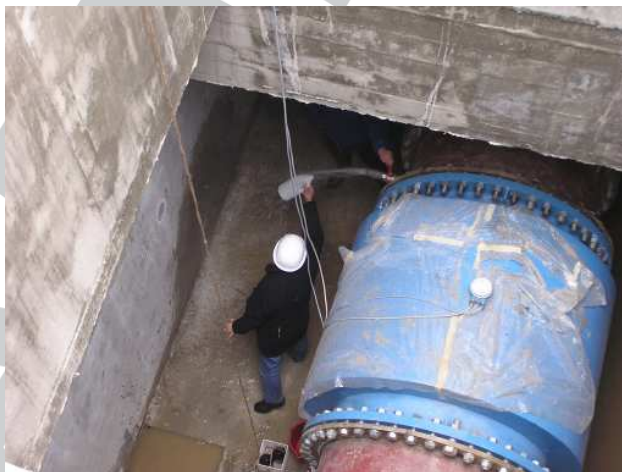
Fig.8 Debitmetre de masurare a volumului de apa produsa de statia Crivina, necesare intocmirii bilantului apei potabile din sistemul de alimentare cu apa al Municipiului Bucuresti
