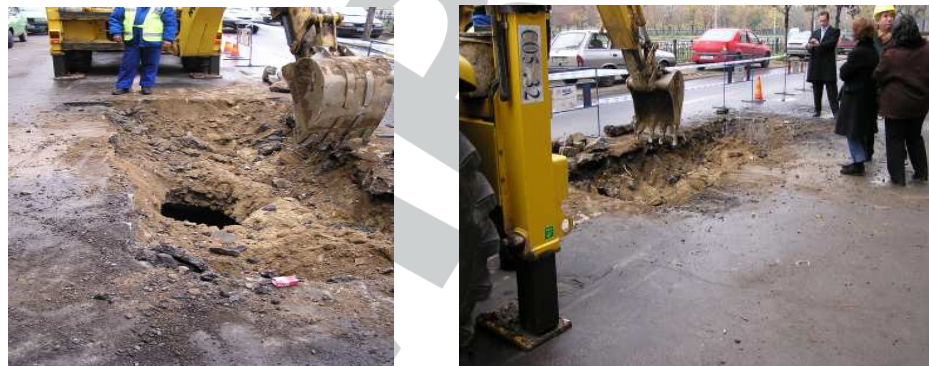
Fig.10 Avarie cu prăbușire de canal colector în Splaiul Independenței și intervenția ANB în termenul prevăzut de contract (3 noiembrie 2005)
